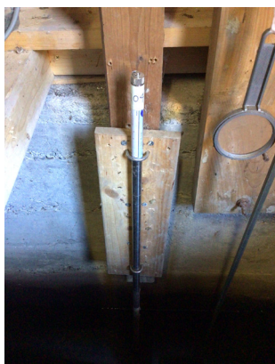
図－17 穴の宮観測小屋に設置してある Trutrack 社製の水位計測口ガー
