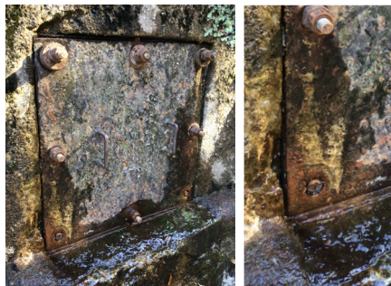
図－27 白坂量水堰の鉄扉固定ボルトが折れている排水孔
