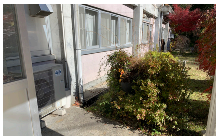
図－28 赤津宿泊施設正面玄関横で見つかった穴の宮浸透試験の小鉢 2022年11月15日撮影、周囲の植え込みの植物と一体化している。
