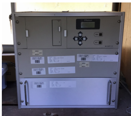
図-16 白坂観測小屋に設置されている水晶式 水位検知システム
